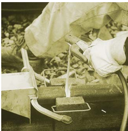
Spojovací svary kolejnic: OK 74.78
